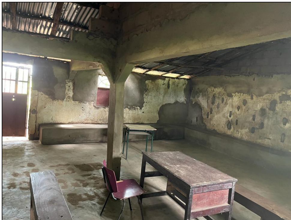
Antes de la rehabilitación
