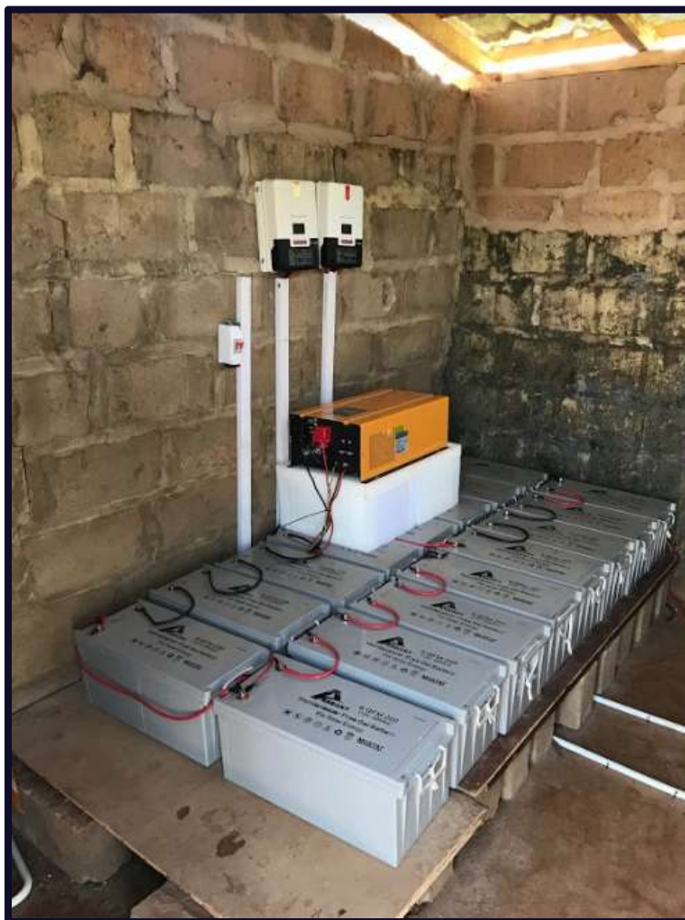
Ilustración 7. Habitación de las baterías del huerto solar.
